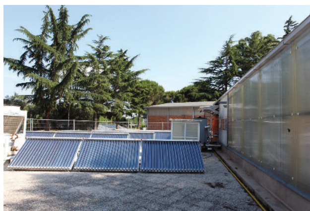
Impianto di solar cooling presso Edificio F96 "Serra a Contenimento" del CR ENEA Casaccia
