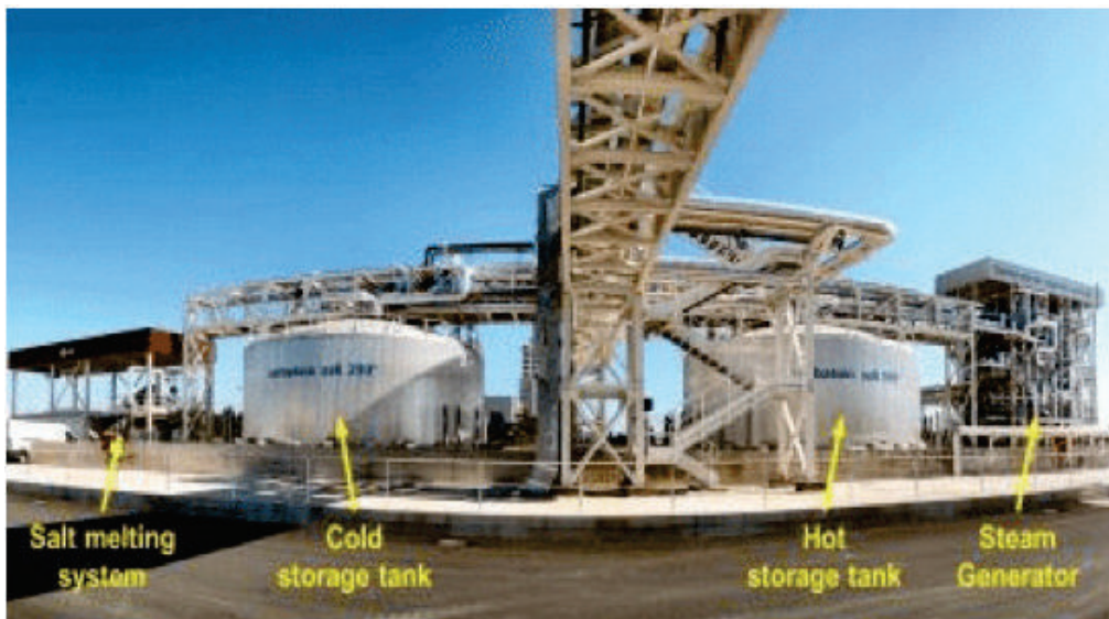
Sistema di accumulo termico da 80MWh a due serbatoi e sali fusi dell'impianto dimostrativo "Archimede" realizzato da ENEL/ENEA a Priolo Gargallo.
